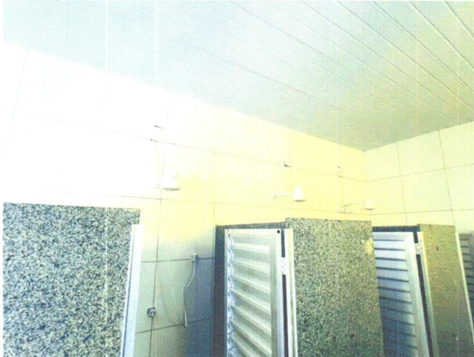
FOTO 45 – INSTALAÇÃO DE CHUVEIRO ELÉTRICO COMUM CORPO PLÁSTICO DO TIPO DUCHA
